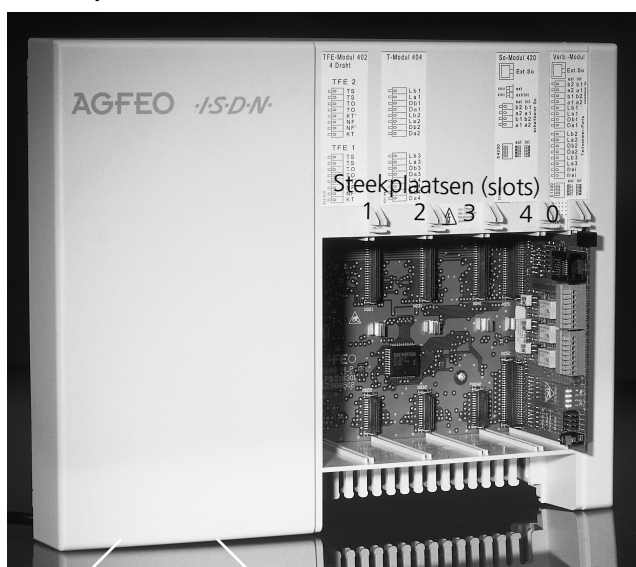
Afb. 1: Telefooninstallatie met afgenomen deksel
